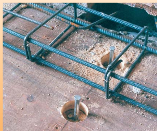
L'assito è stato carotato in corrispondenza delle travi portanti utilizzando un trapano con apposita fresa. Sono state fatte inoltre dei raccordi perimetrali tramite gabbie e ferri a V.
